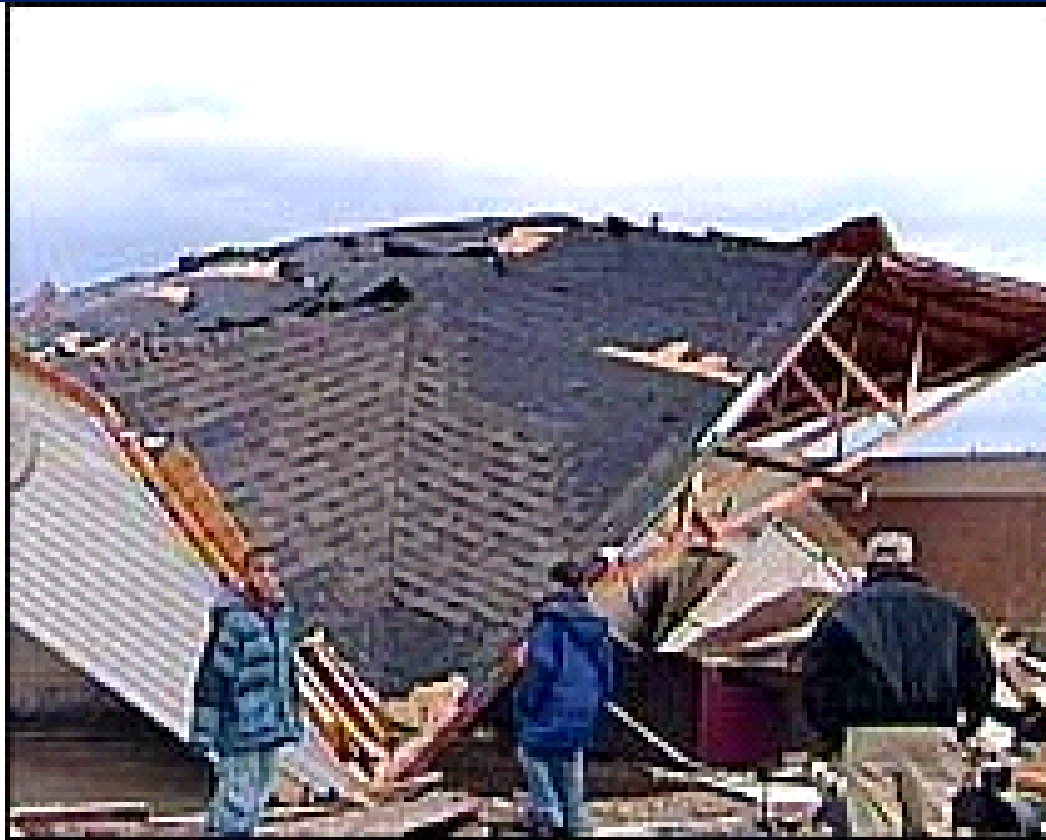
图 1 被大风掀掉的屋顶
